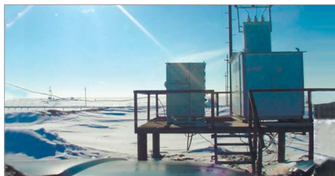
Станция управления «Ритэкс-01» на Сандибинском месторождении. 2003 г.
